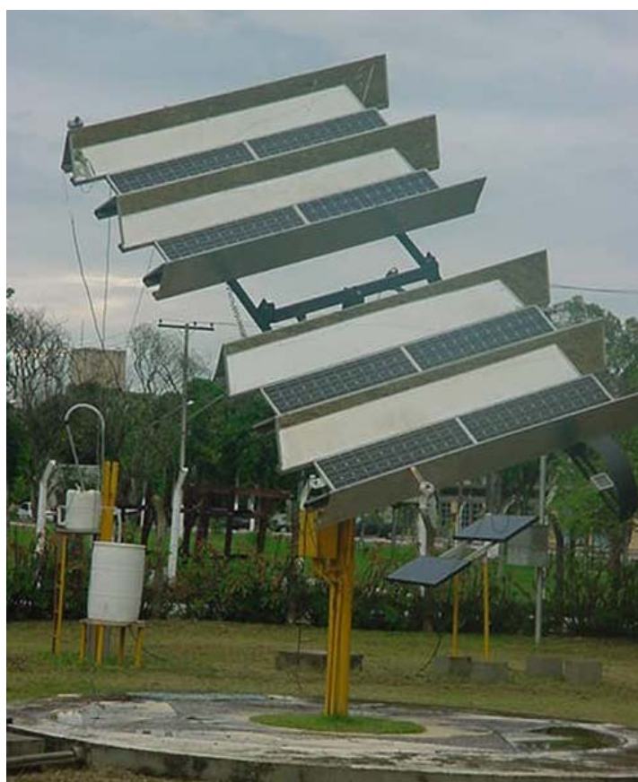
Figura 18 -Vista geral do concentrador fotovoltaico tipo V.
