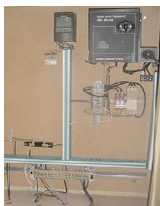
Figura 20 – Inversor de frequência instalado no quadro de comando.
