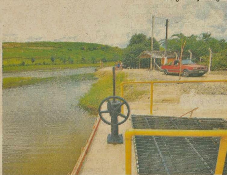
SEM ÁGUA A chave de distribuição da adutora Arataca foi fechada
