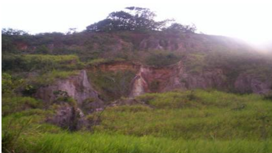
Figura 19 – Erosão em ravinas na borda da mata
