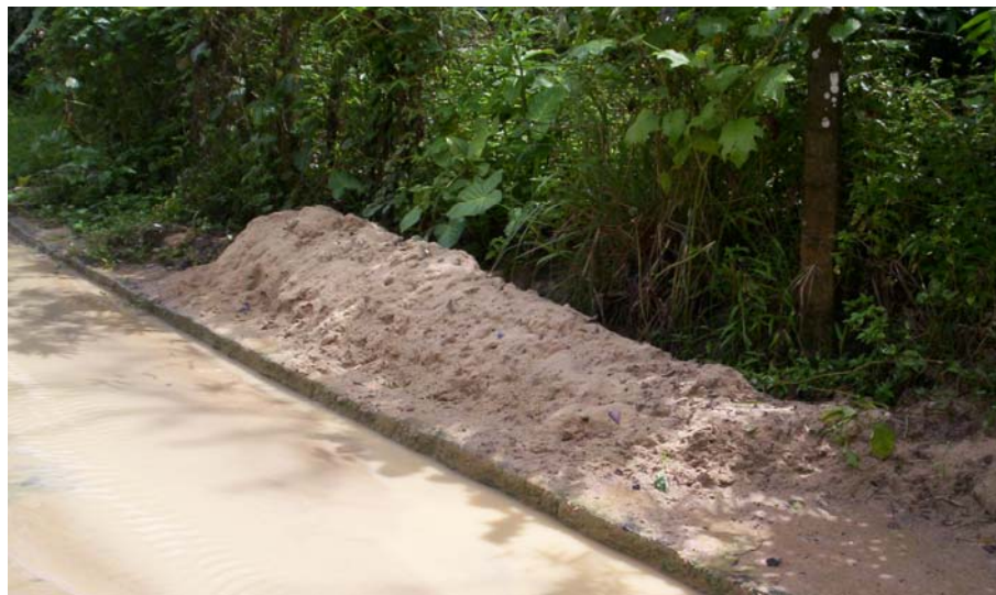
Figura 15 – Material transportado pelas águas da chuva
