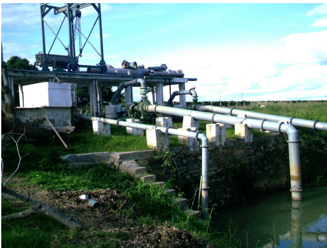
Foto 08: sistema de bombeamento da água do Rio São Francisco para a irrigação.. Fonte: Michel Saturnino Barboza, 2008.
