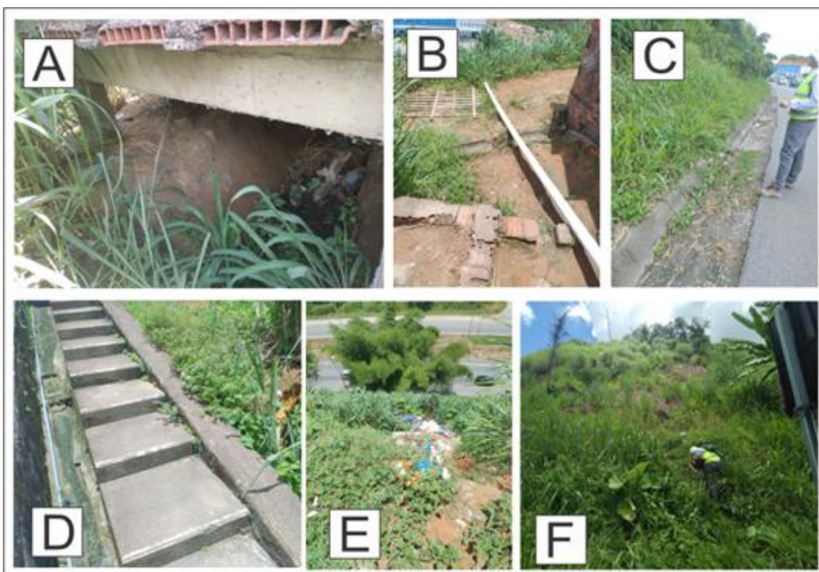
Figura 29: Visita técnica realizada na encosta situada no Alto da Telha; A) Moradia no topo do talude com erosão e acumulação de resíduos abaixo da estrutura da casa; B) Formação de crosta compactada no solo e lançamento de esgoto na face do Talude; C) Drenagem danificada indicando esforços passivo na base do talude; D) Drenagens comprometidas na escadaria e encanação usada para compartilhamento das águas servidas (cor azul); E) Lançamento de resíduos sólidos sobre o talude no primeiro plano e bambuzal na base do talude em segundo plano; F) Alto grau de saturação na base do talude com surgência de água. Fonte: Produzido pelo autor.
