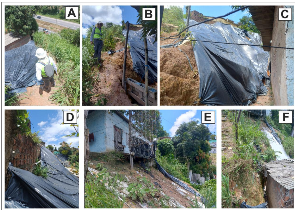
Figura 30: Todas as imagens representam ângulos do mesmo contexto, localizado na parte sul do talude. A e B) Escadaria improvisada, esculpida por moradores, apresentando aspectos erosivos em seu percurso. C e D) Talude coberto por lona plástica preso no muro da residência acima e apresentando uma distância de 40 cm entre a base e a moradia à jusante. E) Perda significativa de solo abaixo da casa azul. F) Declividade acentuada da casa azul e moradia inferior a 15 cm do corte. Fonte: Produzido pelo autor.
