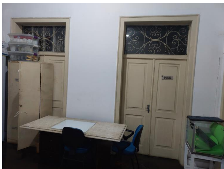
Figura 50 – Portas que dão acesso à Reserva Técnica trancadas e/ou obstruídas
