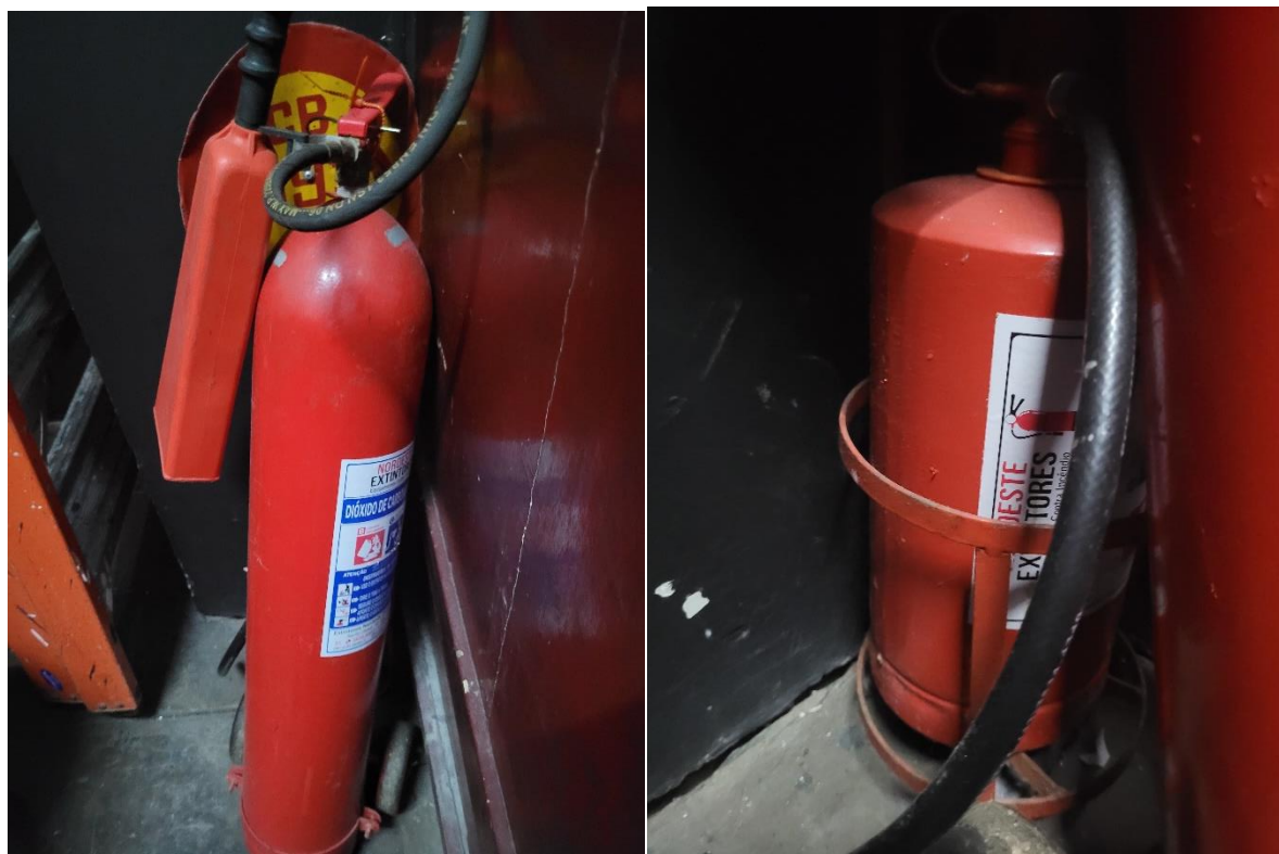
Figura 46 – Extintores de CO 2 na coxia do teatro
