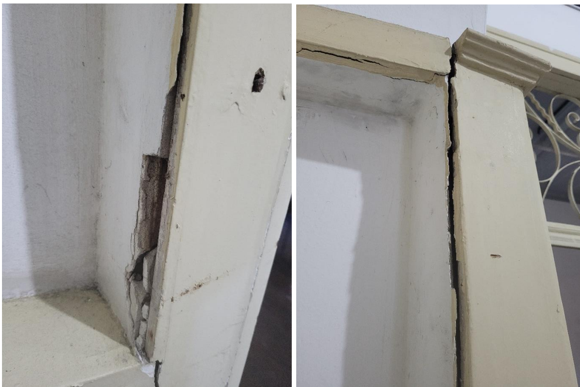
Figuras 35 e 36 – Degradação das paredes e madeiras
