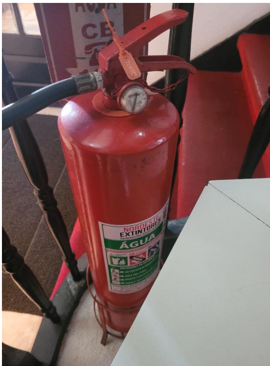
Figura 48 – Extintor de água na base da escada
