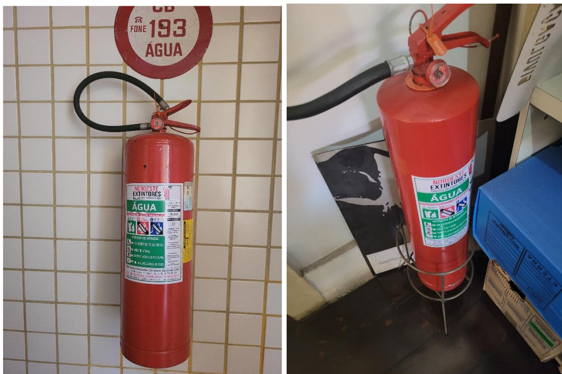
Figura 47 – Extintores de água próximos aos W.Cs do pavimento superior (esq.) e à sala da Reserva Técnica (dir.)
