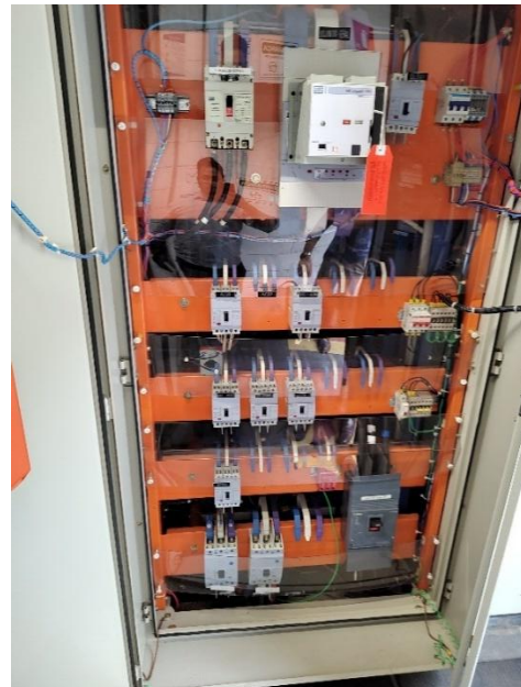
(b) Quadro elétrico da Decathlon após a retirada do multimetido
