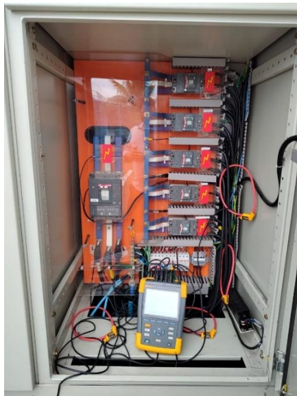
(a) Quadro elétrico de suprimentos dos carregadores – com multimetido instalado
