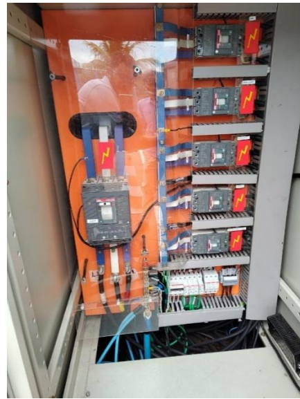
(b) Quadro elétrico de suprimentos dos carregadores – após a retirada do multimetido
