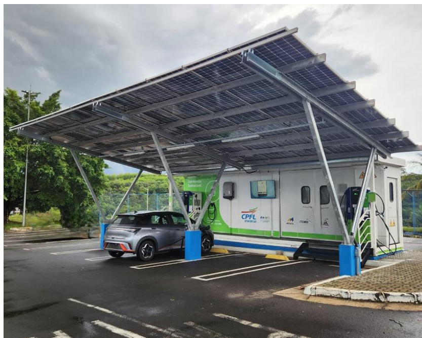
Figura 13 - Estação de recarga instalada na Decathlon
