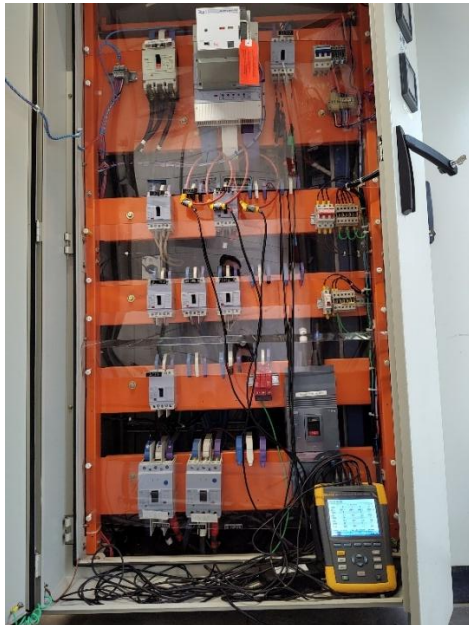
(a) Quadro elétrico da Decathlon com multimetido instalado
