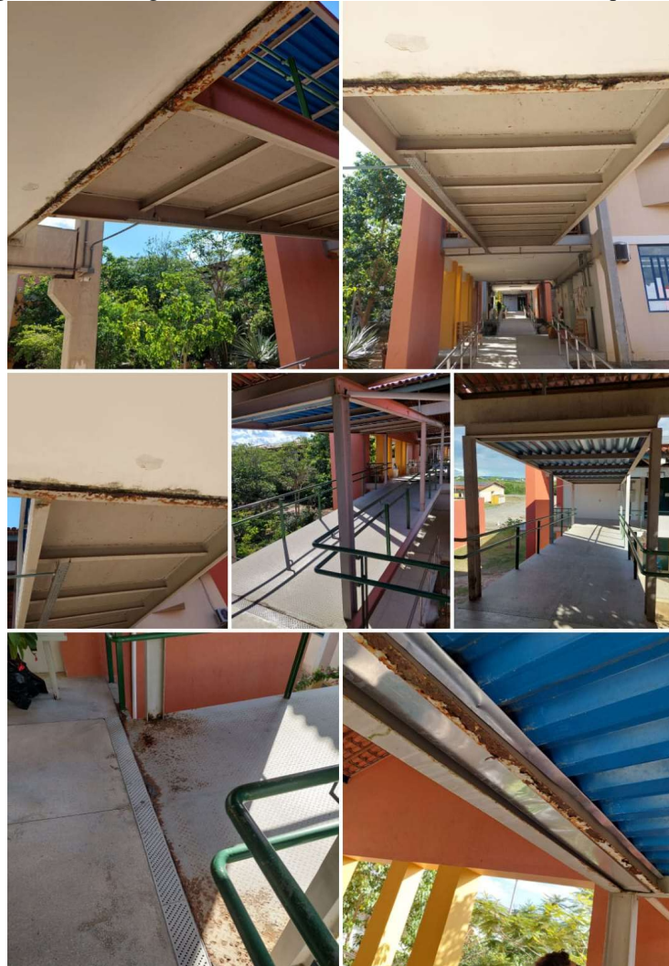
Figura 6 – Patologias identificadas em elementos estruturais das passarelas
