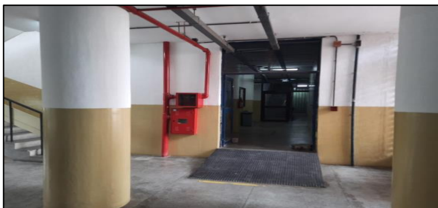
Figura 26 – Corredor 1º andar do CFCH- sistema de combate a incêndio e rampa
