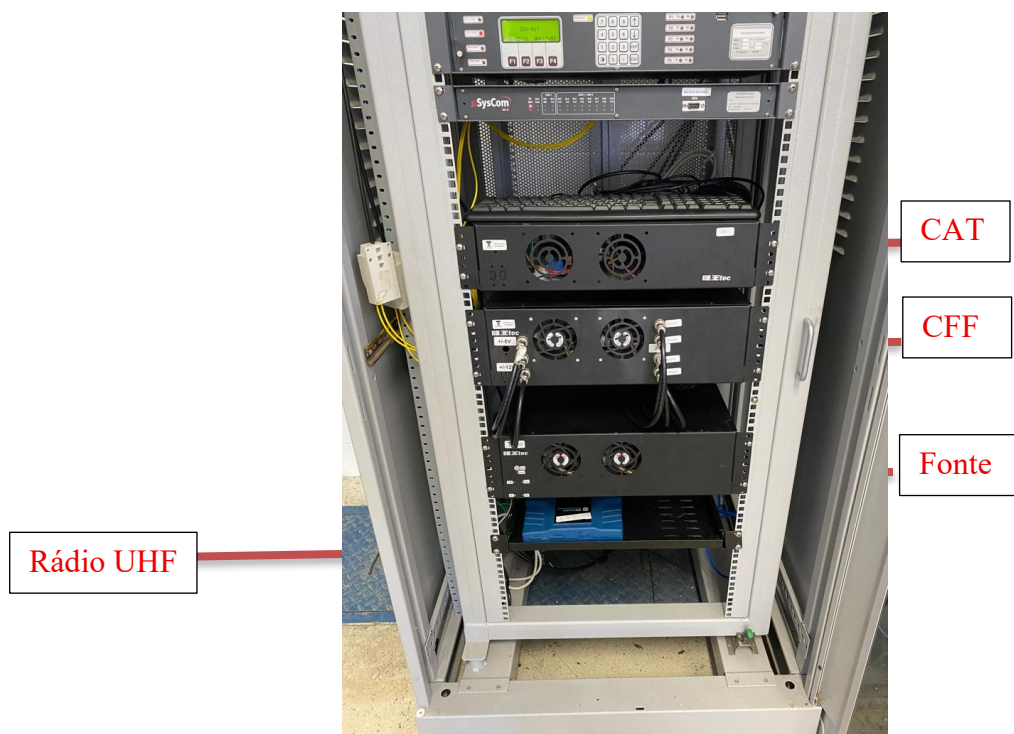
Figura 108- Foto dos três módulos instalados no rack na subestação de Suape
