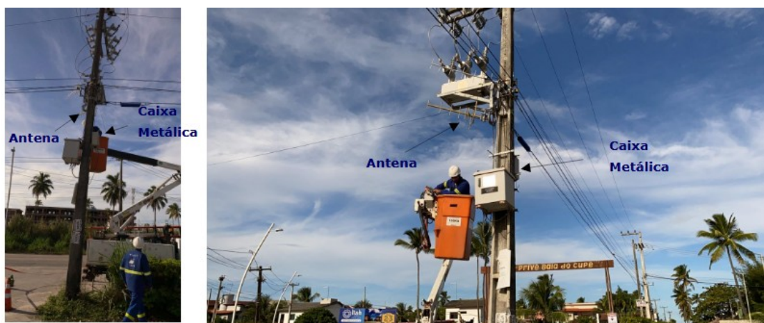
Figura 117- Caixa remota instalada na RT4
