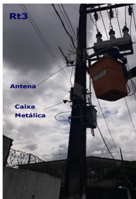
Figura 114- Caixa instalada na RT3
