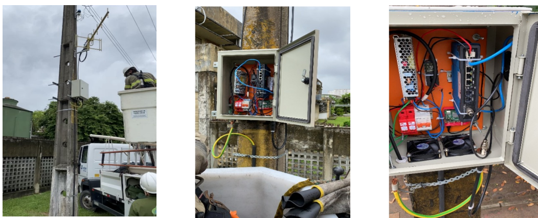
Figura 52- Foto das Caixas metálica instalada nos postes do Campus da UFPE
