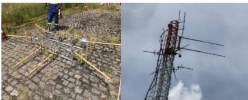
Figura 109- Foto dos arranjos de antenas instalados na subestação de Suape
