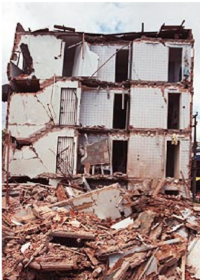
Figura 1.4 – Edifício Éricka após o desastre
