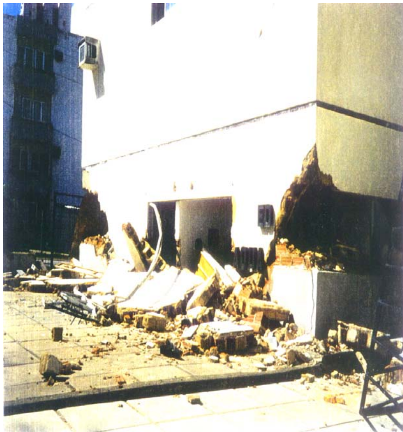
Figura 4.2 – Edifício Aquarela após o acidente
