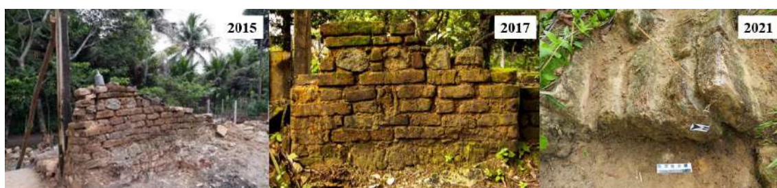
Figura 81: Degradação da alvenaria de tijolos do Engenho Jaguaribe
