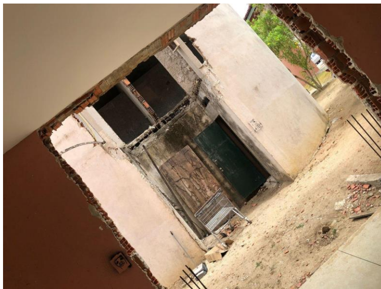
Figura 7 – Estrutura de banheiros construídos e nunca utilizados no campus de Caruaru – Dezembro de 2021
