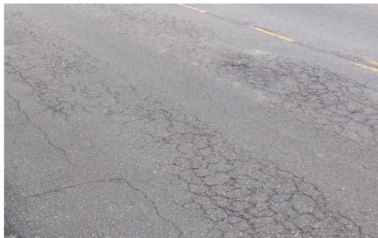
Figura 22 – Trincas “Couro de Jacaré” associada à fadiga da mistura asfáltica
