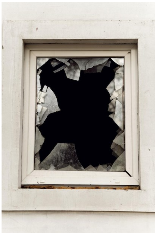
Figura 23 - Figura de Janela quebrada
