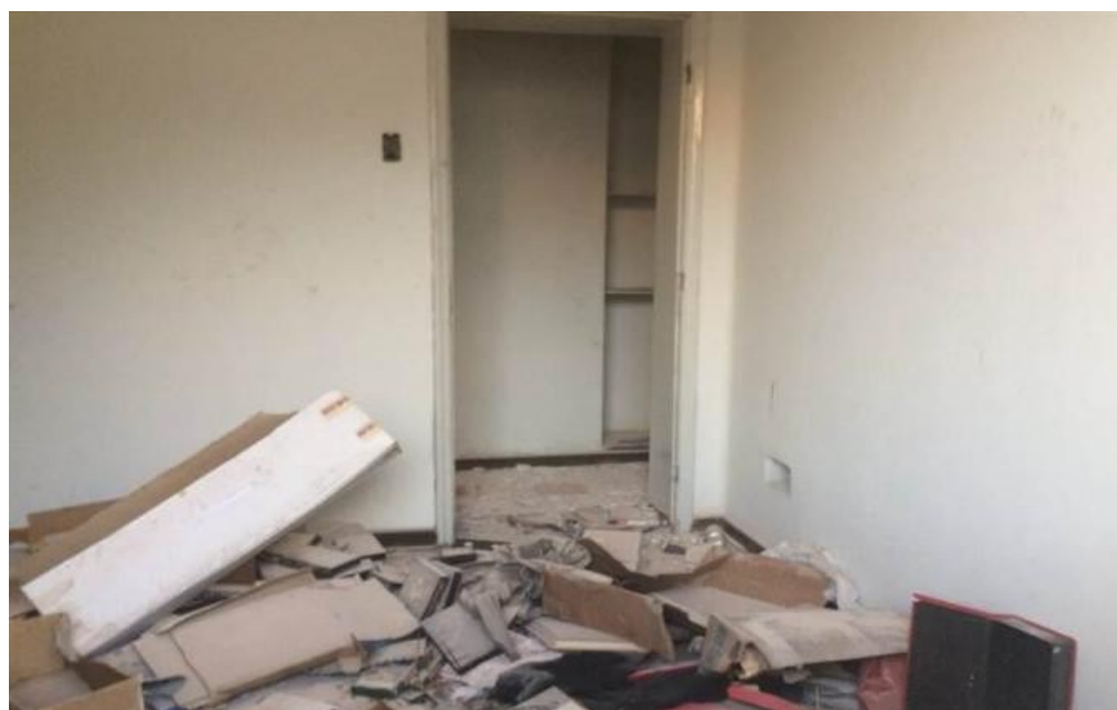
Fig 43. Destroços da Prédio/ Edifício Monte Castelo. Fonte: Jota Nogueira
