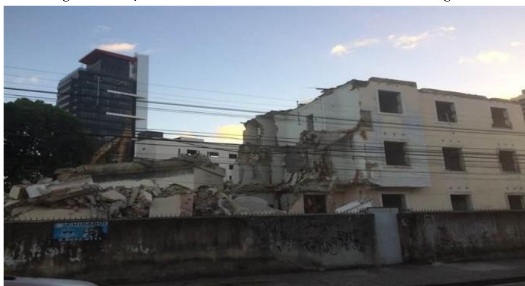
Fig 44. Destroços da Prédio/ Edifício Monte Castelo. Fonte: Jota Nogueira
