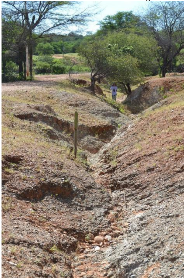
Figura 91 - Ravina na área do sítio Estrada da Lagoa do Aldemar.
