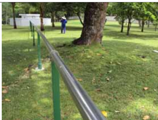
Foto 31 – Tubulação adutora de condução da água vinda da fonte
