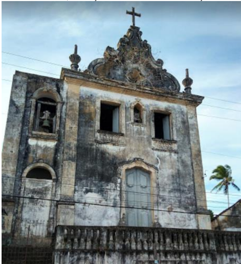
Figura 19 - Igreja do Amparo no ano de 2018. Percebe-se que, apesar de ainda utilizada pela comunidade, a edificação estava em mal estado de conservação.
