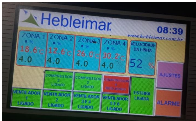
Figura 6 - Registro do painel do túnel de resfriamento
