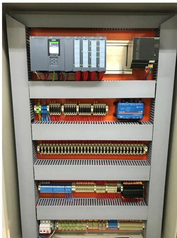
Figura 8 – Quadro de Automação.
