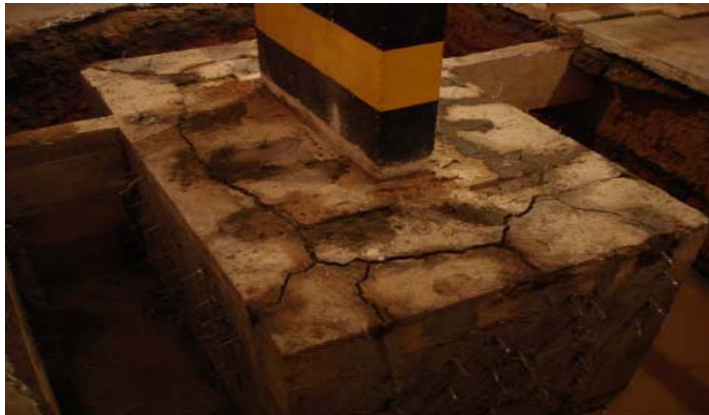
Figura 1.1 – Largas fissuras em blocos de fundação de um edifício residencial em Recife (ANDRADE, 2006).
