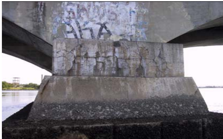
Figura 1.2 - Fissuras e trincas em bloco da ponte Paulo Guerra em Recife (HELENE et al. , 2006).
