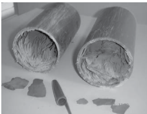
Figura 1-Tubulação de água obstruída por óxidos de cálcio (Mendonça et al. , 2008).
