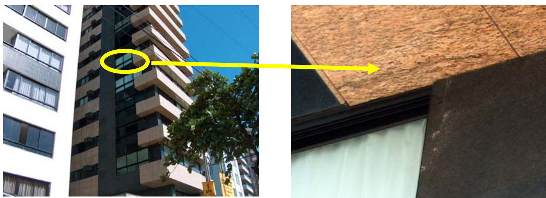
Figura 20: revestimento do tipo não-aderente fissurado na posição do “insert” metálico.
