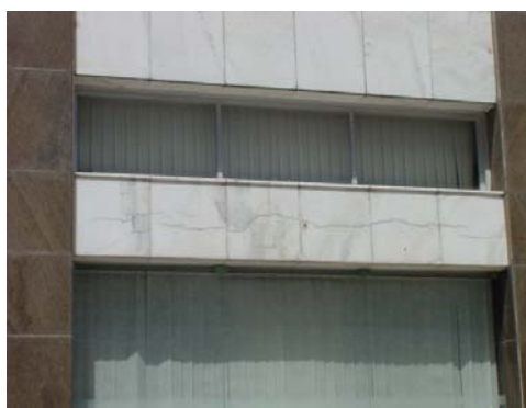
Figura 19: revestimento do tipo aderente fissurado.
