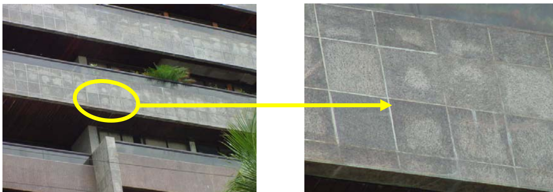
Figura 14: Manchamento em um revestimento de fachada na cidade do Recife assentada segundo a técnica de grande espessura.
