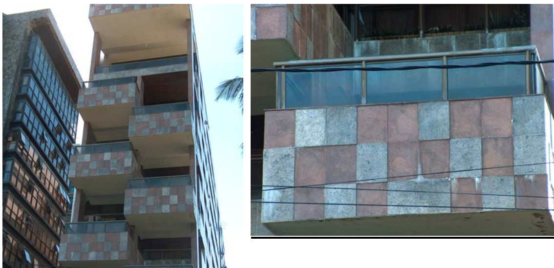
Figura 18: Eflorescência em revestimento de fachada na cidade do Recife.
