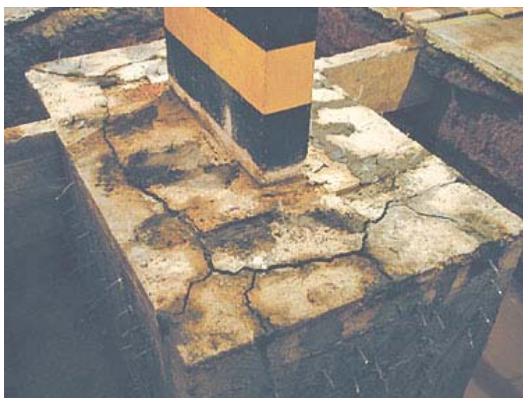
Figura 1.1 - Bloco de fundação de edifício da RMR afetado por RAS (Andrade, 2006).
