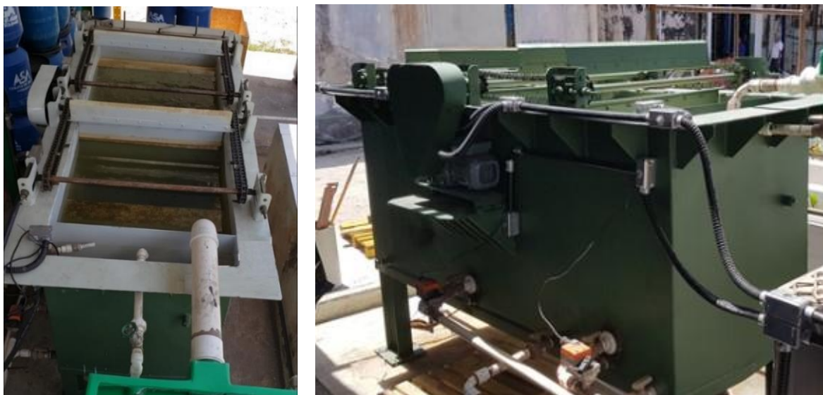
Figura 20 - Flotador FPSI-SI instalado na planta utilizados nos ensaios experimentais
