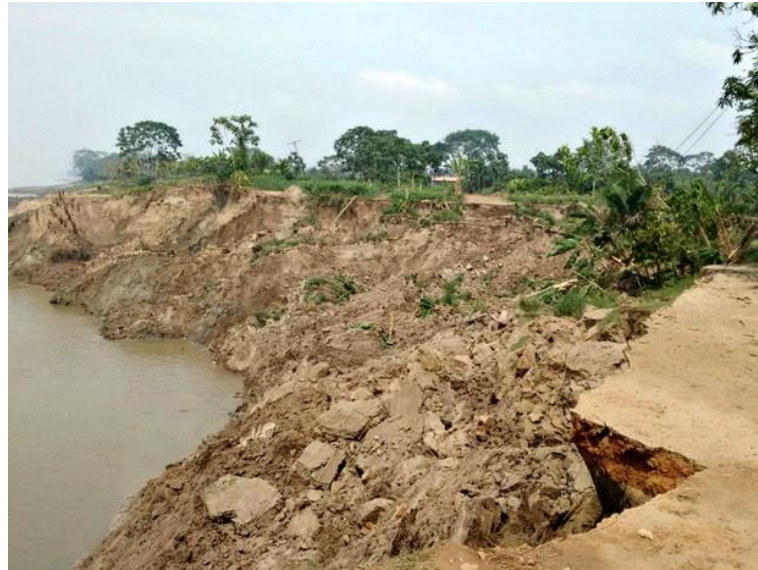
Figura 3 - Solapamento das margens.
