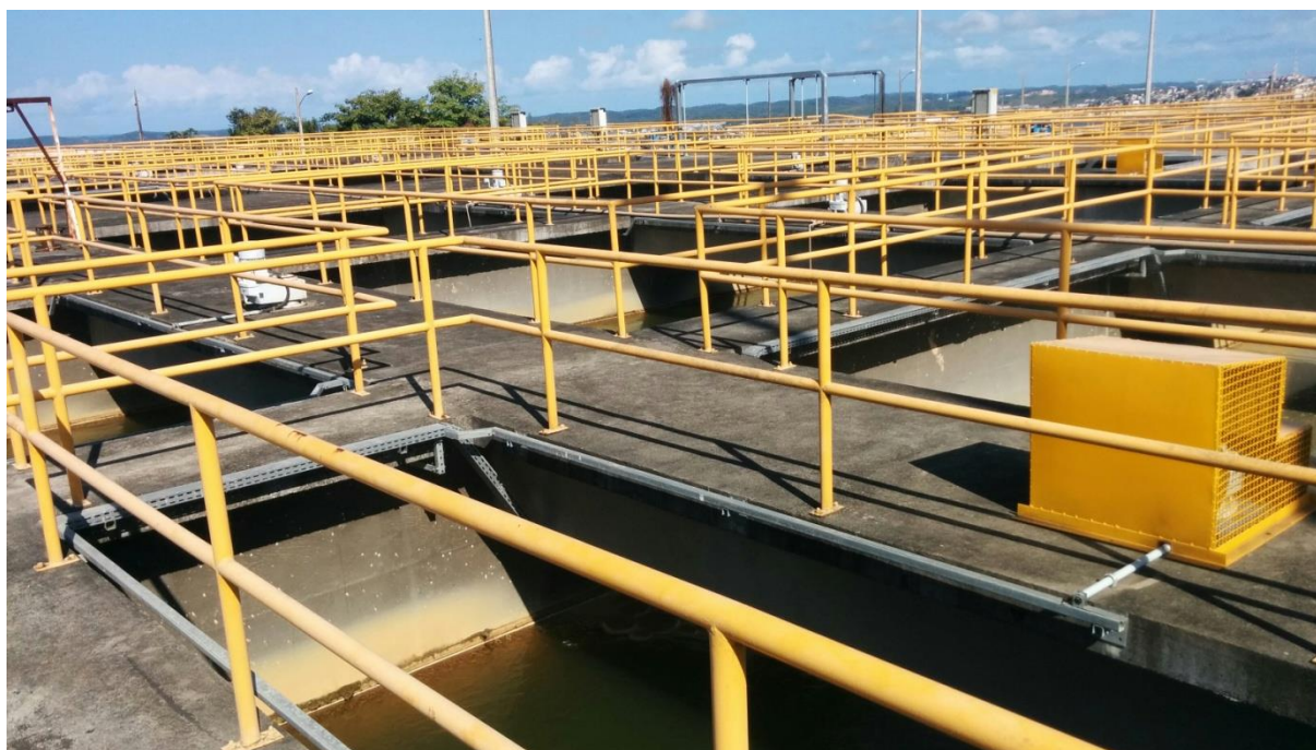
Figura 3 - Floculadores na ETA Pirapama-PE.
