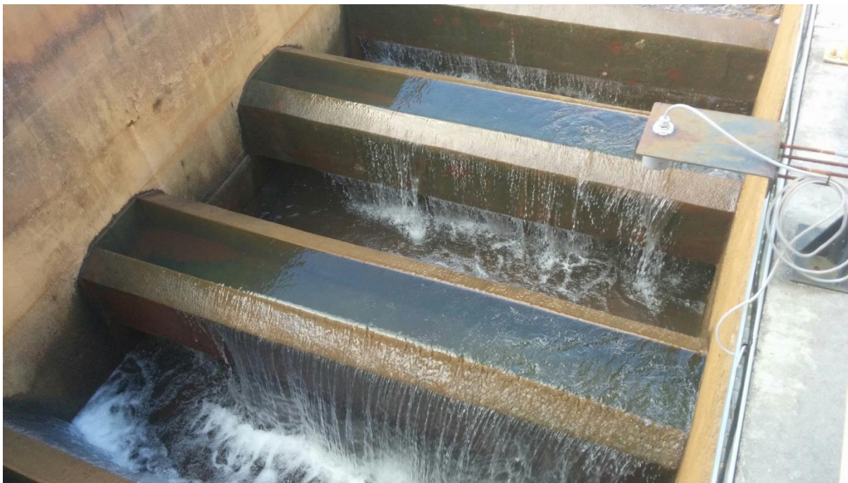
Figura 5 - Filtros na ETA Pirapama-PE.
