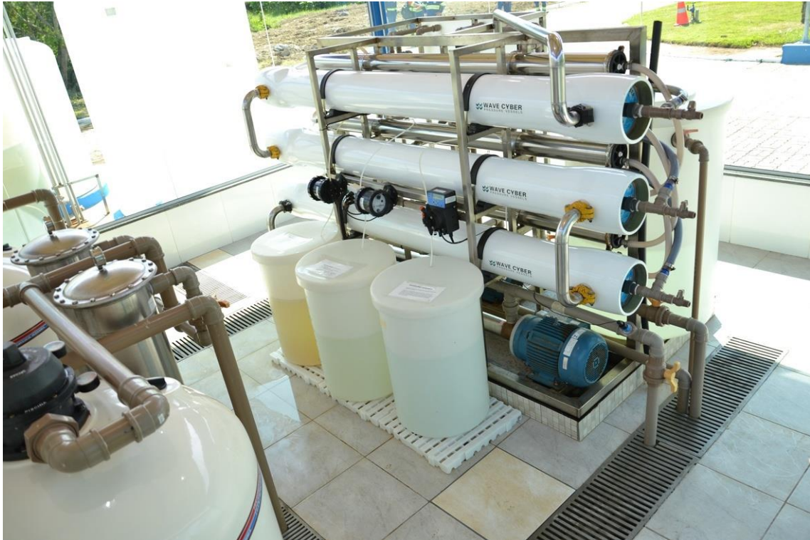
Figura 11 - Estação de tratamento de Osmose Reversa.
