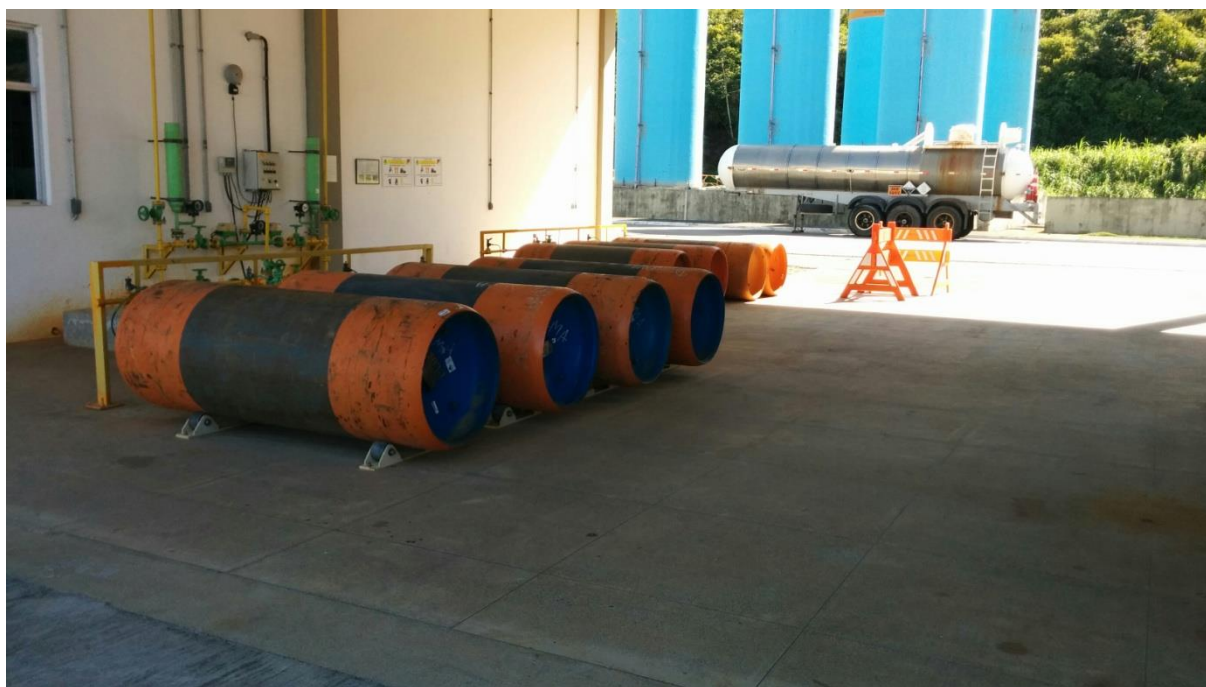
Figura 6 - Tanques de cloro na ETA Pirapama-PE.
