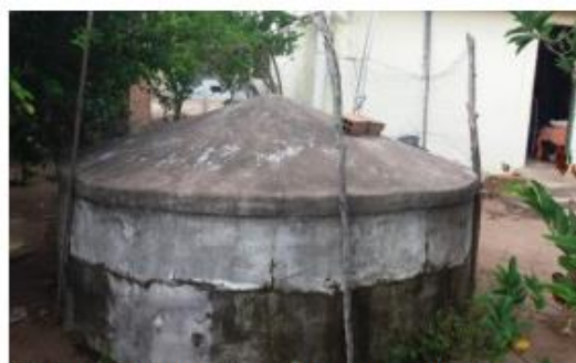
Figura 2. Cisterna de placas. Fonte: Maria A. F. dos Santos (2019).
