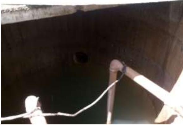
Figura B9 – Reservatório da ETACP
