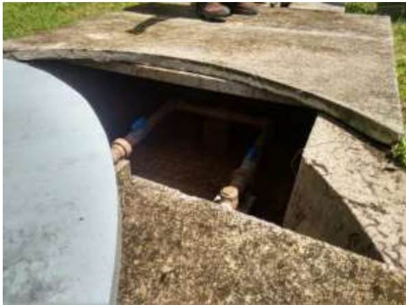
Figura B11 – Reservatório ETACP
