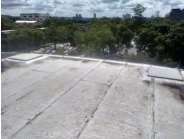
Figura B15 – Reservatório superior
