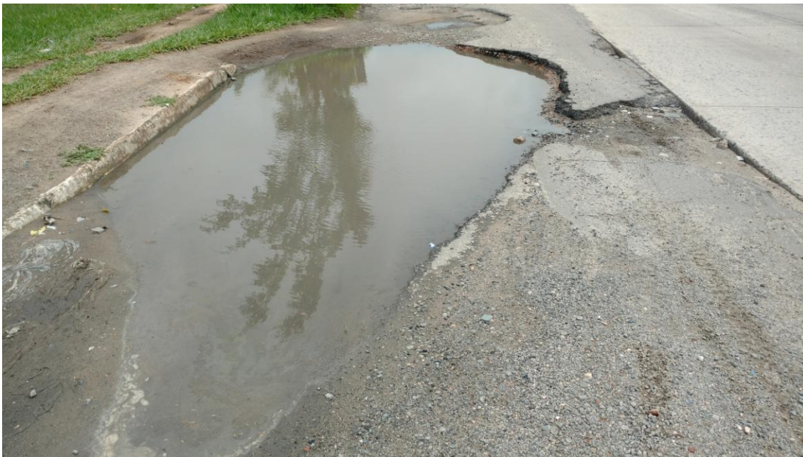
Figura 19 - Buraco no acostamento em péssimo estado de conservação, Km 57 da BR-101. (Fonte: Borba, Guilherme C. L.)
