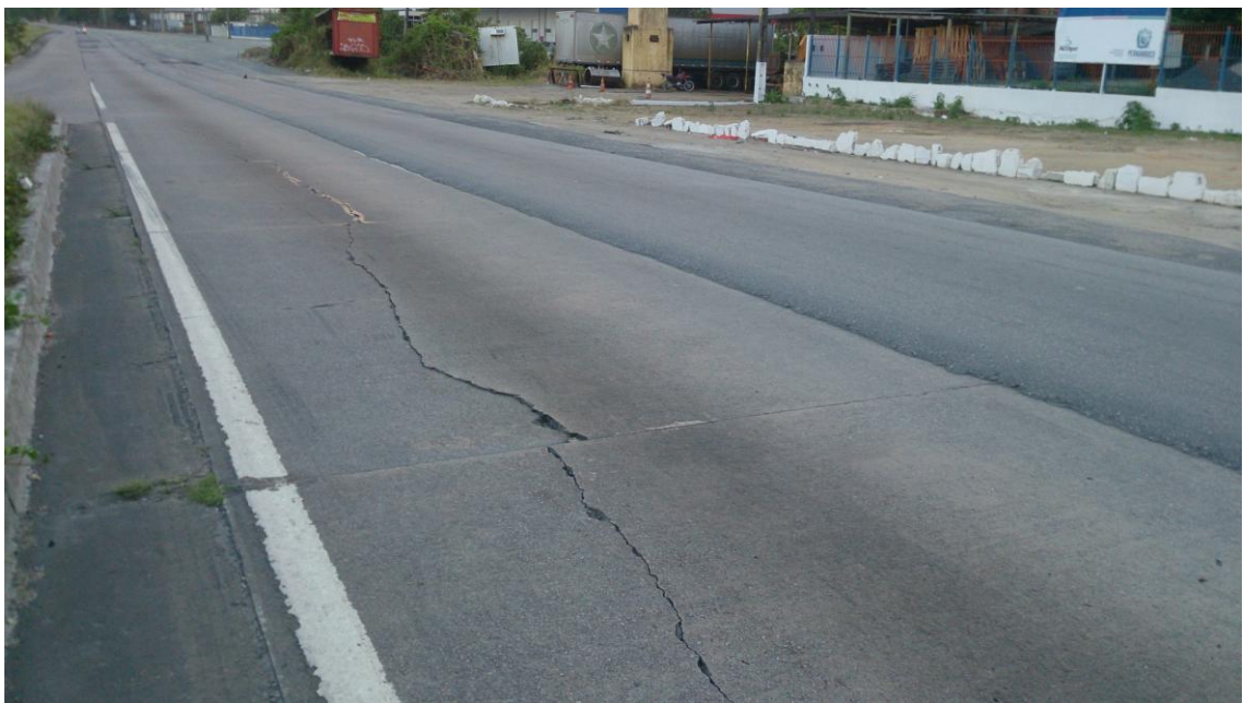
Figura 10 - Fissuras lineares. (Fonte: Borba, Guilherme C. L.)
