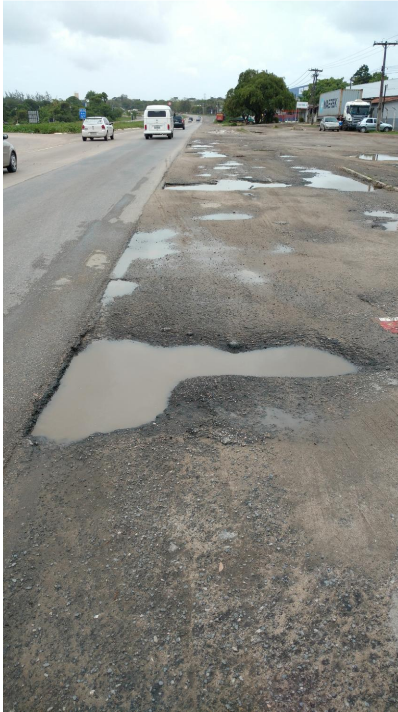
Figura 17 - Acostamento com elevado grau de deterioração, Km 57 da BR-101. (Fonte: Borba, Guilherme C. L.)
