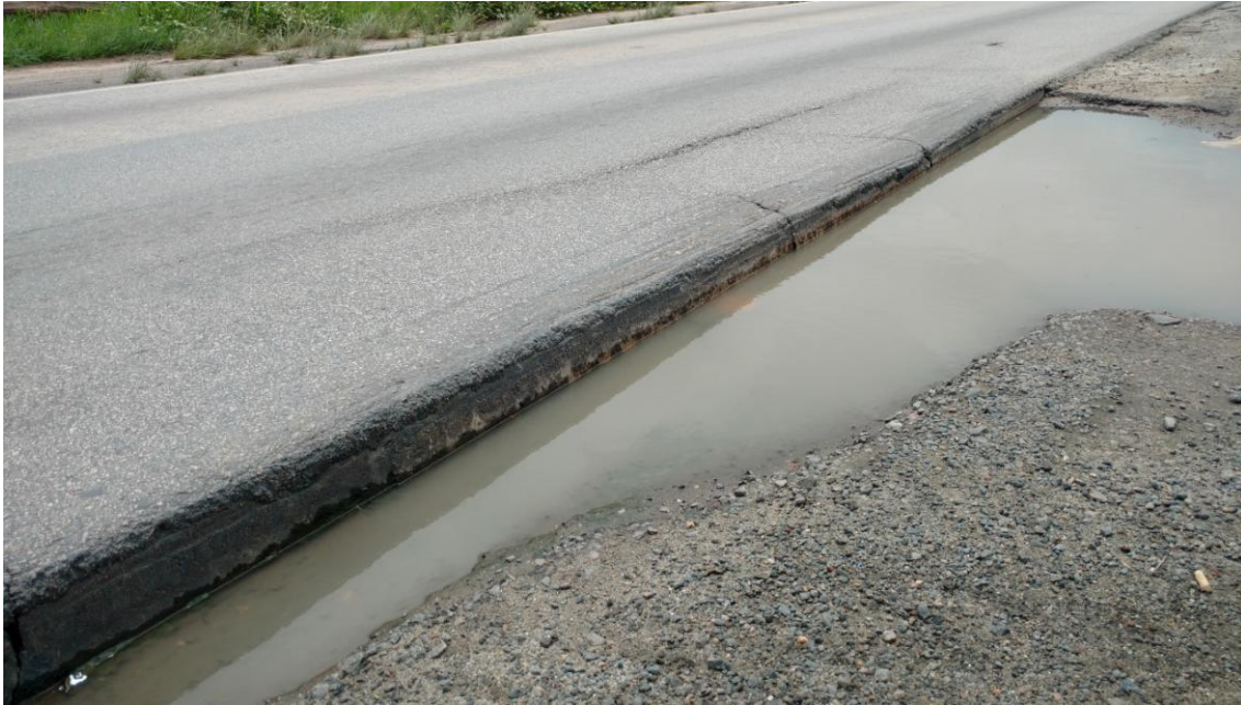
Figura 18 - Desnível da faixa de rolagem para o acostamento e buraco no acostamento, Km57 da BR-101. (Fonte: Borba, Guilherme C. L.)
