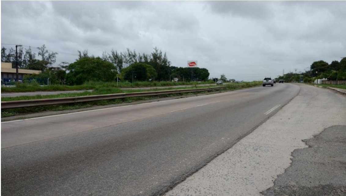
Figura 15 - Sinalização horizontal com elevado grau de desgaste, Km 57 da BR-101. (Fonte: Borba, Guilherme C. L.)
