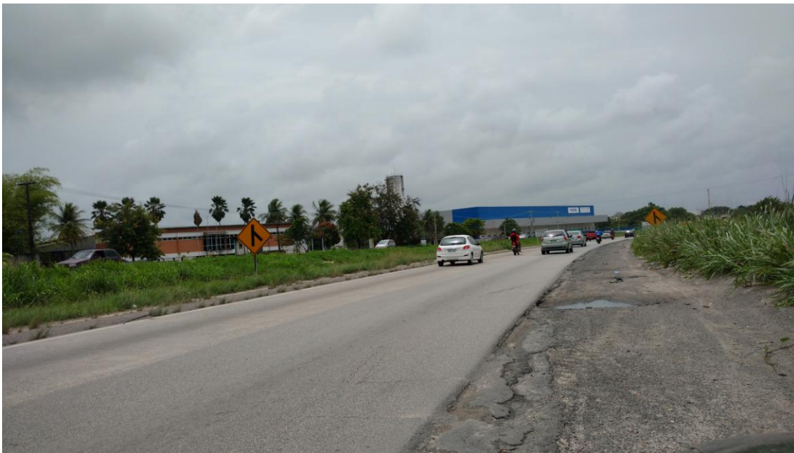
Figura 16 - Ausência de sinalização horizontal, Km 57 da BR-101. (Fonte: Borba, Guilherme C. L.)
