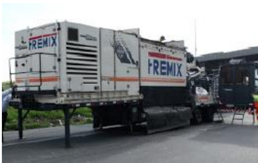
Figura 11– Usina Móvel - Reciclagem em Planta.
