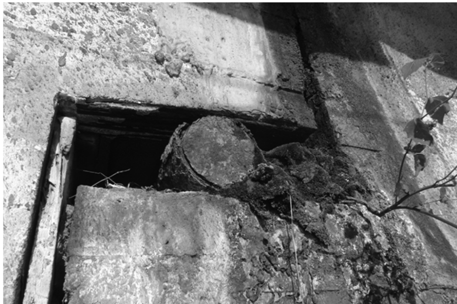
Figura 1.3 – Aparelho de apoio e junta danificados por infiltração – Ponte sobre o Rio Poxim – Aracaju / SE (foto Mauricio Pinho)
