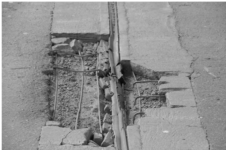
Figura 1.5 - Junta expansível de neoprene deteriorada (foto Mauricio Pinho)
