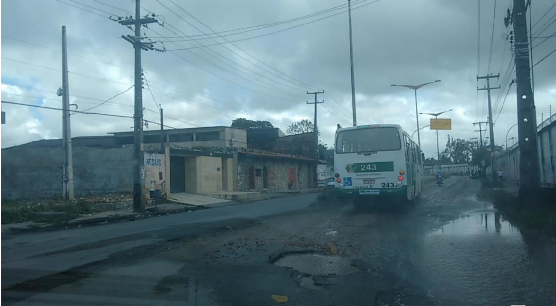
Figura 17- Buracos na Via 3/3
