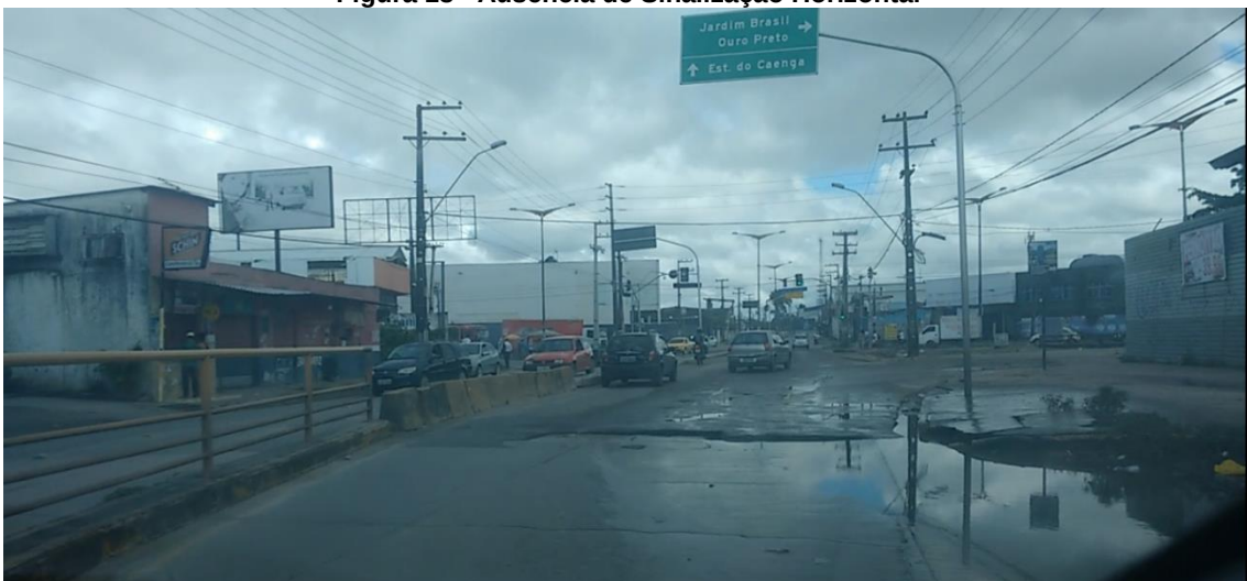
Figura 18 - Ausência de Sinalização Horizontal
