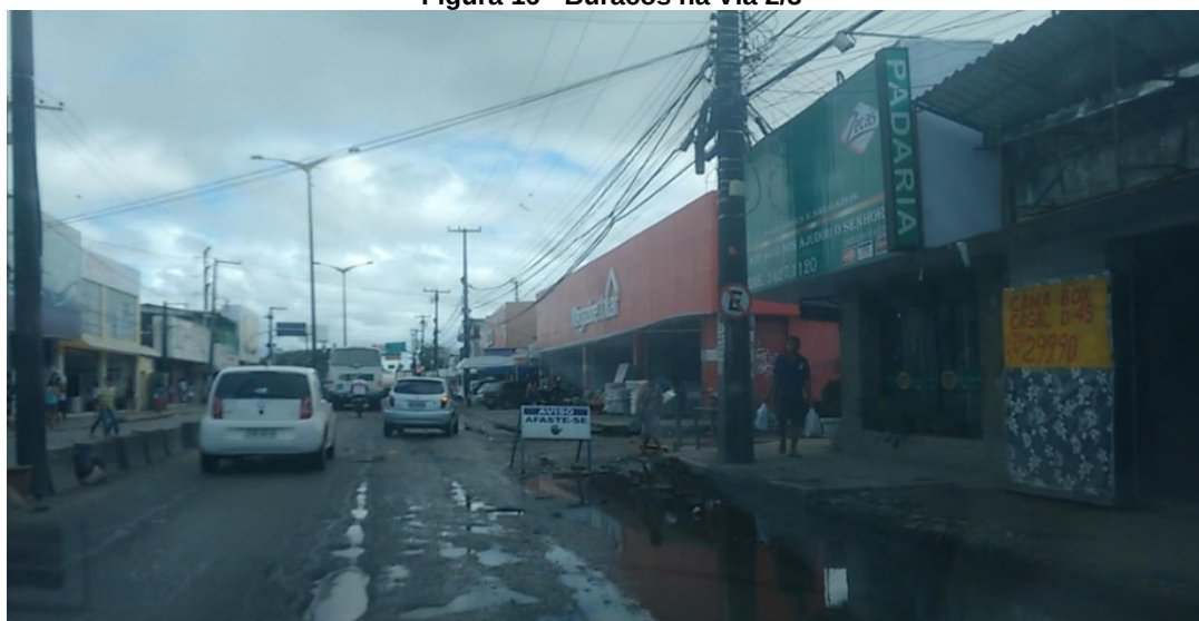
Figura 16 - Buracos na Via 2/3
