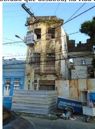
Figura 72 - Sobrado em situação precária ao lado de outro sobrado que desabou, na Rua da Glória
