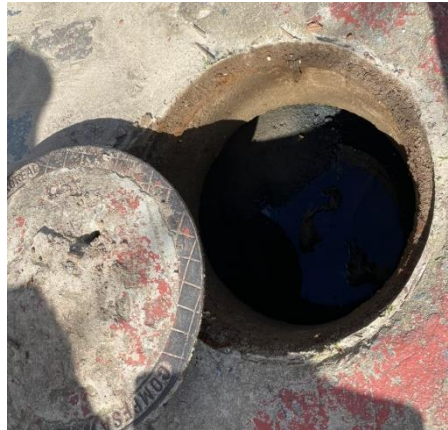
Figura 36: Poço de Visita cheio de esgoto
