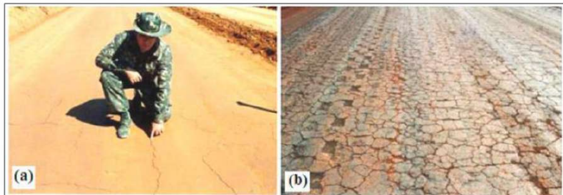
Figura 2.17 – Padrão de trincamento de uma camada de base rodoviária laterítica na Amazônia, em a) imediatamente após a compactação e b) depois de 48h (imprimada com CM-30).
