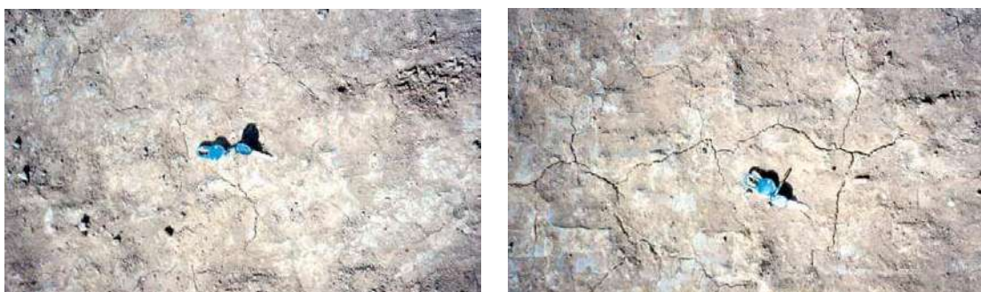
Figura 2.16 – Padrão de trincamento na base de solo fino, trecho experimental 2 da pesquisa de Rezende (2003), (a) logo após a compactação e (b) 48h após a compactação.
