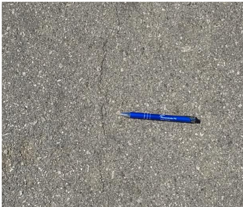
Figura 21 - Fissura encontrada na estação 29
