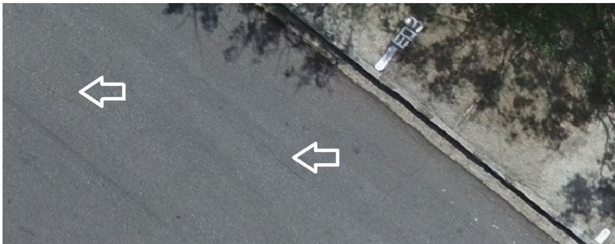
Figura 27 - Trinca longitudinal (Observada a partir do drone)
