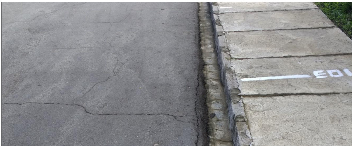
Figura 23 - Trincas transversais encontradas na estação 01
