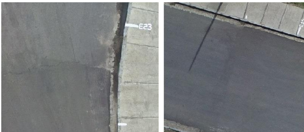
Figura 31 - Remendo (Observado a partir do drone)
