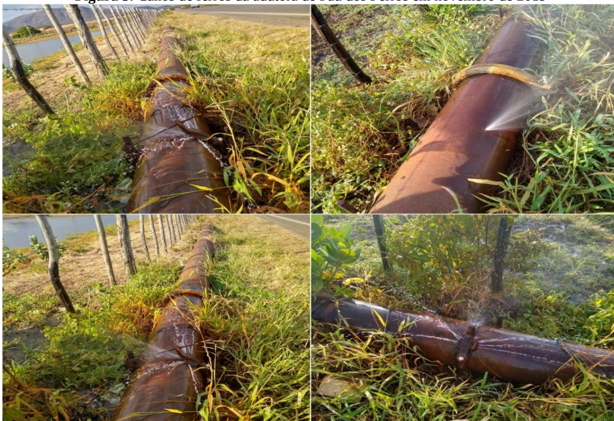
Figura 3: Canos de ferros da adutora de Pau dos Ferros em novembro de 2019
