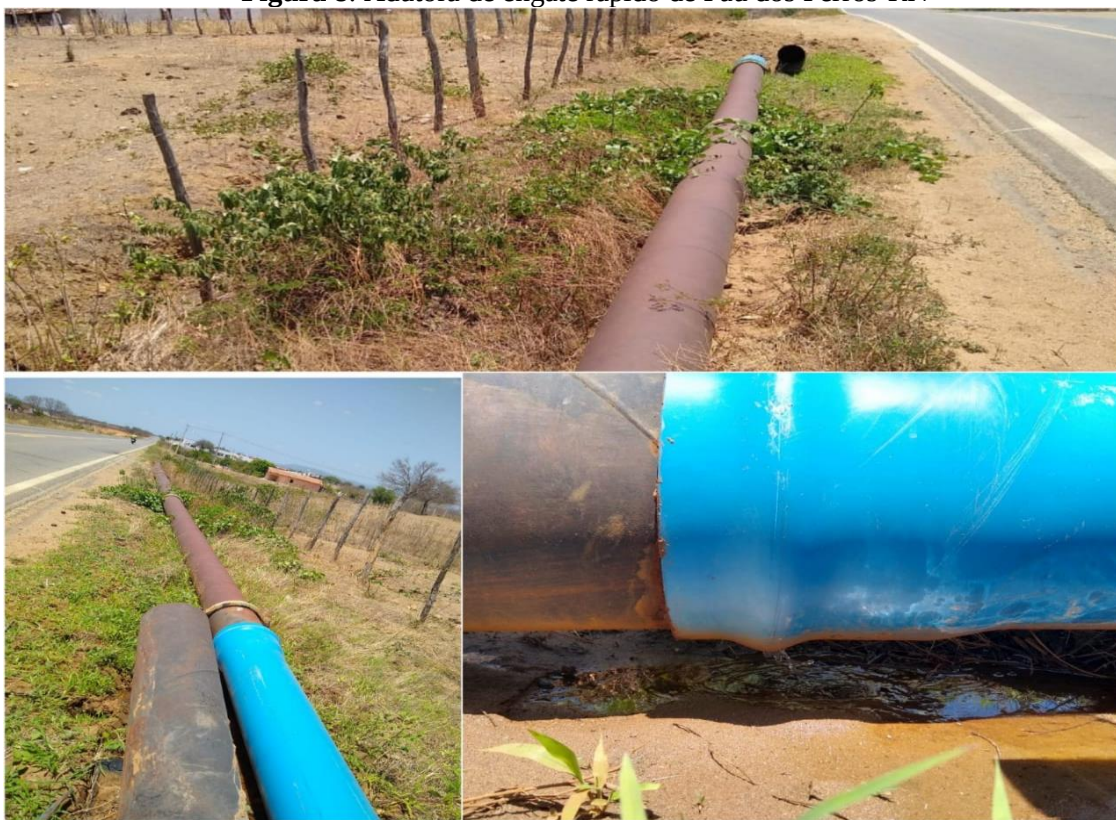
Figura 8: Adutora de engate rápido de Pau dos Ferros-RN
