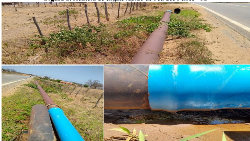
Figura 2: Adutora de engate rápido de Pau dos Ferros - RN
