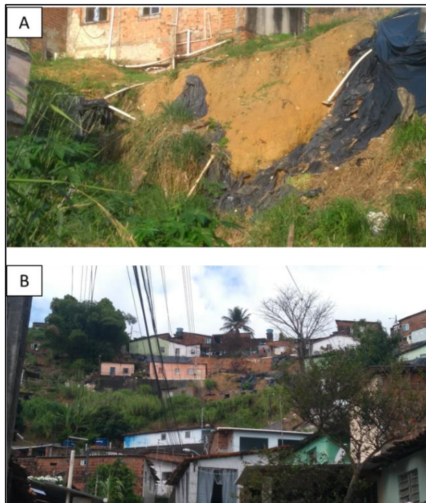
Figura 19 - Ações antrópicas que influenciam na deflagração de escorregamentos. A) Água servida diretamente nas encostas. B) Realização de cortes e aterros para a construção de moradias.
