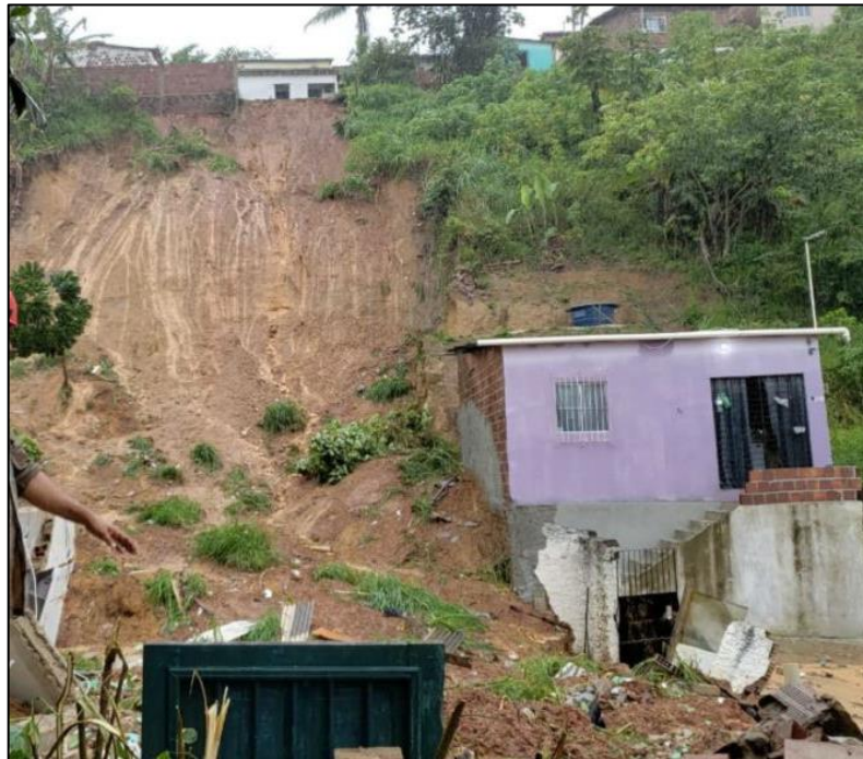
Figura 5 - Escorregamento translacional ocorrido no município de Olinda, Região Metropolitana do Recife.
