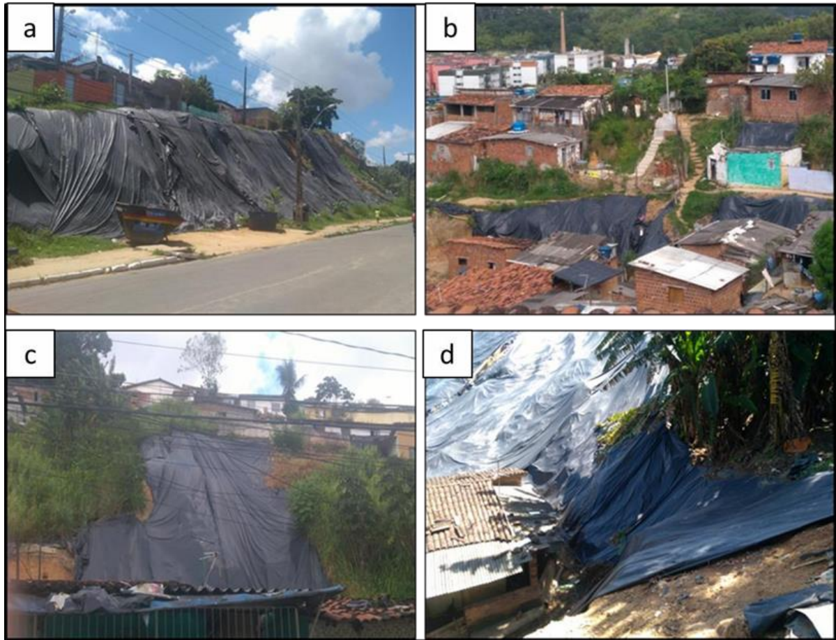
Figura 20 - Áreas de encostas, com ocupações antrópicas, cobertas por lonas desgastadas em bairros da zona norte do Recife. a) Guabiraba, b) Macaxeira, c) Nova Descoberta, d) Dois Unidos.
