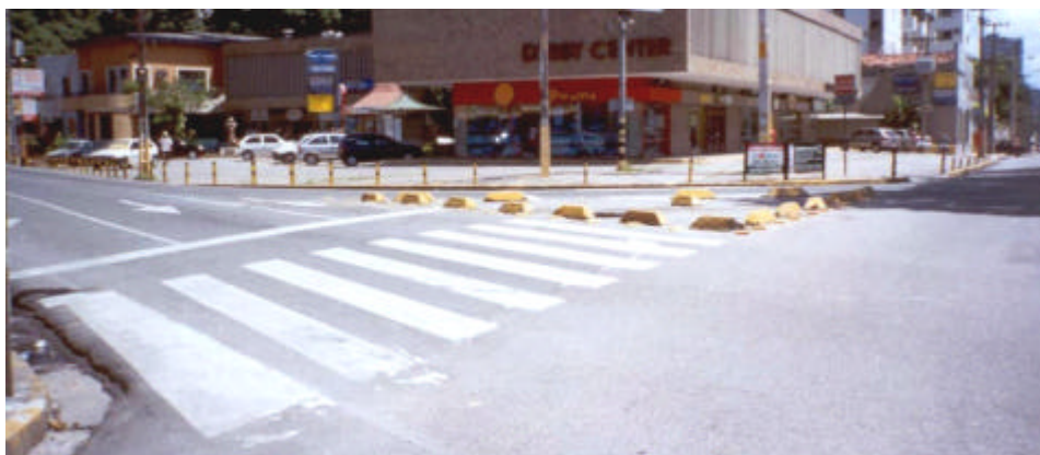
Fotografia 5 – Ausência de Rampas – Presença de Obstáculos
