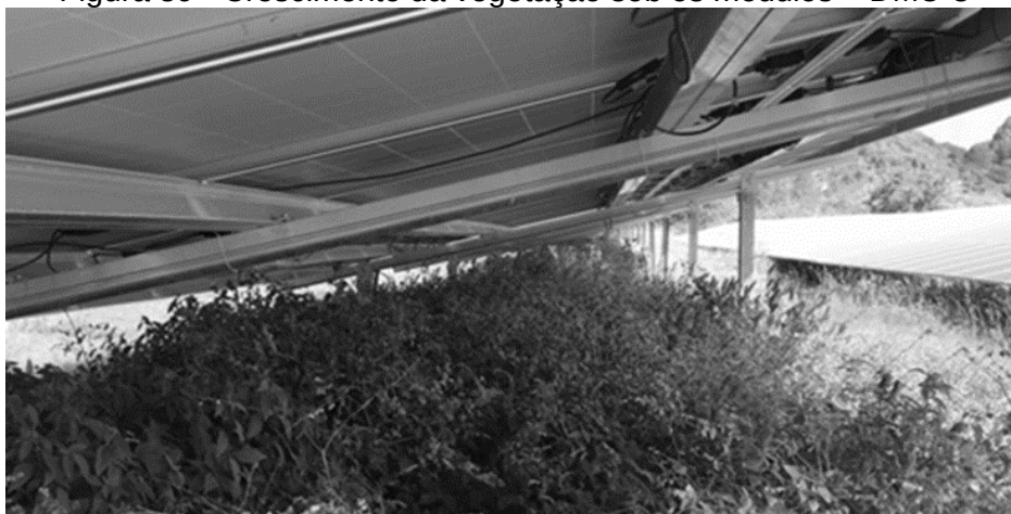
Figura 89 - Crescimento da vegetação sob os módulos – DMU-3
