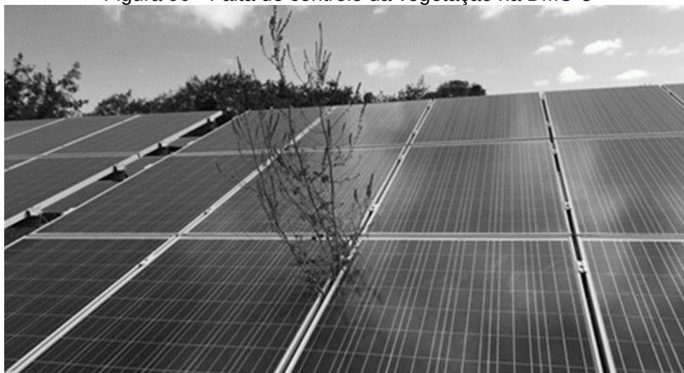
Figura 90 - Falta de controle da vegetação na DMU-3
