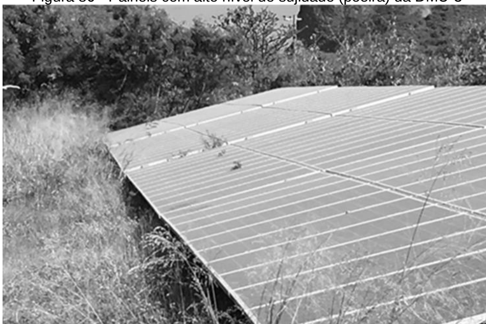
Figura 86 - Painéis com alto nível de sujidade (poeira) da DMU-3
