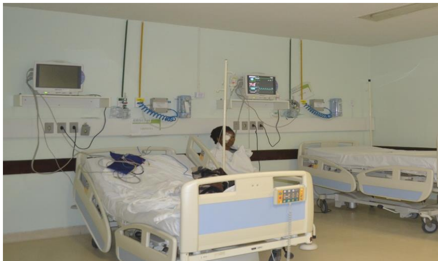
Figura 25 - Vista da Sala de Recuperação Anestésica do Centro Cirúrgico Ambulatorial – HC/UFPE
