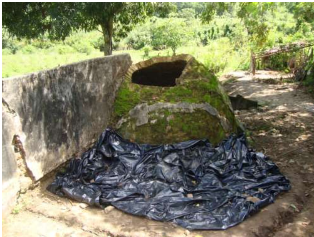
Figura 23 – Dano na parte superior da abóbada
