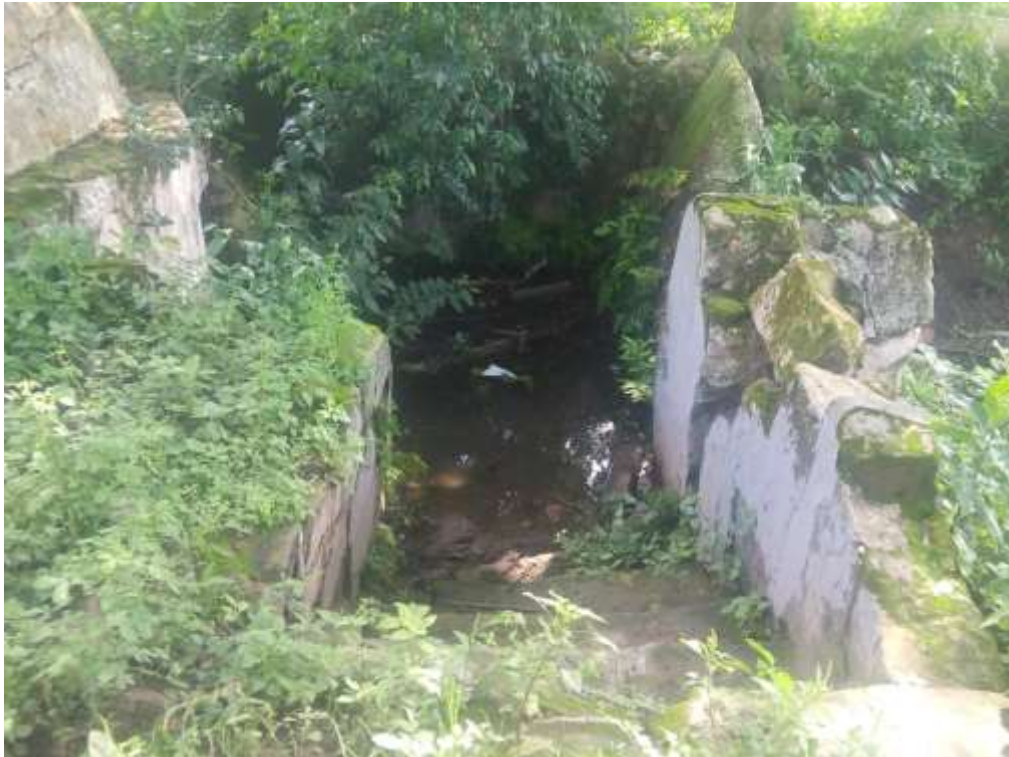
Figura 21 – Tanque localizado à direita da abóbada
