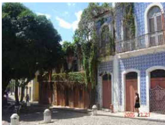
Figura 202 – Ruína bem no coração da Praia Grande. Fonte: Natália Vieira / Julho de 2005.
