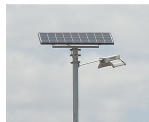
(C) Iluminação Solar Kraft Foods , Vitória de Santo Antão – PE
