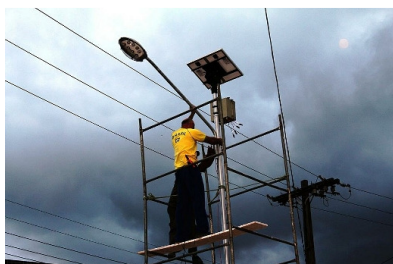
(A) Iluminação Solar Belo Jardim-PE
