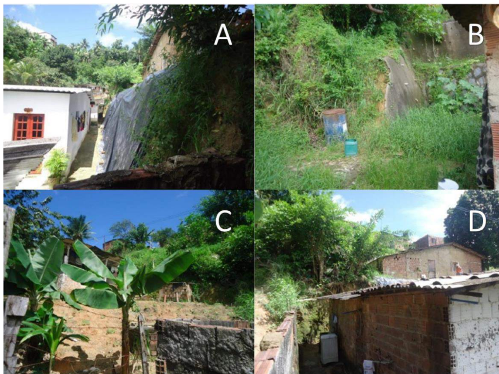
Figura 7.5 – Registro fotográfico detalhado. A) moradia próxima ao talude de corte com declividade acentuada, protegida por uma lona plástica, evidenciando que já houve um movimento de massa. B) rachadura no muro de contenção evidenciado pela cicatriz de deslizamento. C) Solo exposto com presença de bananeiras, podendo resultar no acúmulo de grandes quantidades de água. D) proximidade da moradia ao talude de corte contribuindo para o consequente aumento no grau de vulnerabilidade - Exemplo: Setor PE-OL-SR-02.
