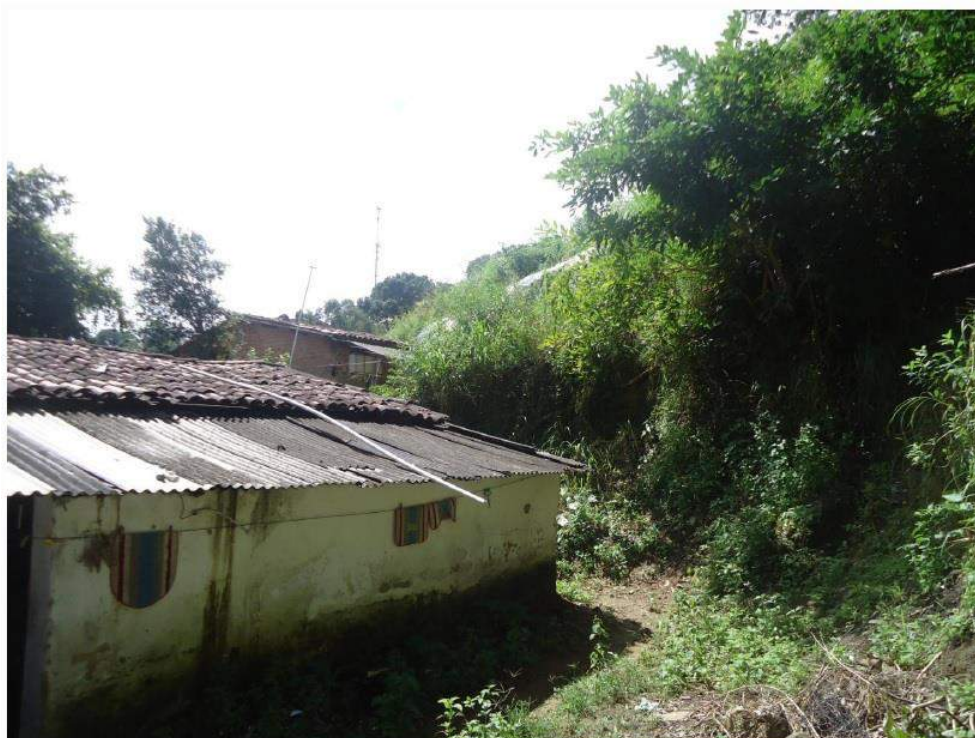
Figura 7.4 – Registro fotográfico geral do setor, evidenciando a ocupação desordenada na encosta, por uma moradia de baixo padrão construtivo, através de cortes do tipo gaveta - Exemplo: Setor PE-OL-SR-02.
