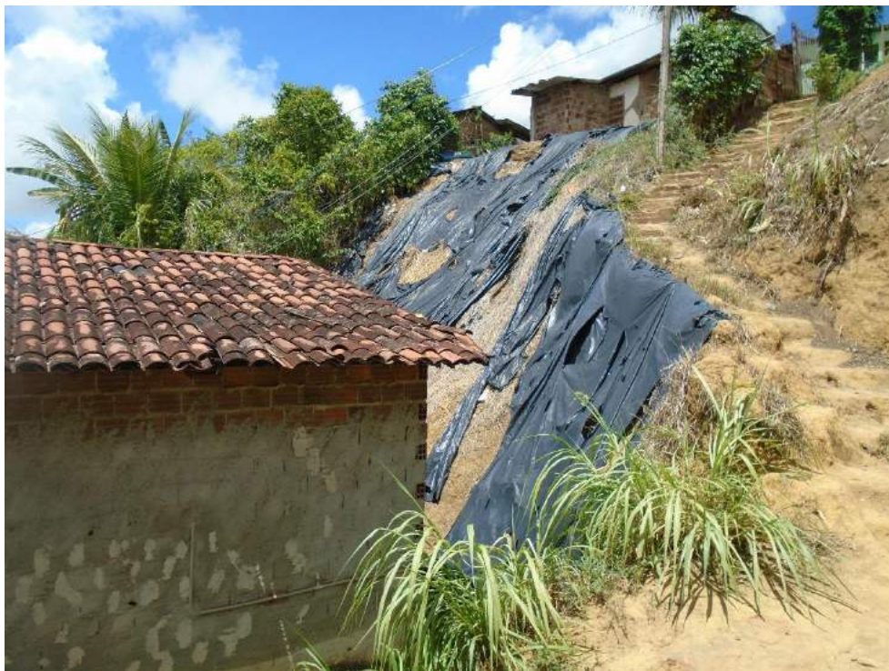
Figura 7.2 – Registro fotográfico do setor, evidenciando a ocupação desordenada na encosta, por uma moradia de baixo padrão construtivo, através de corte inadequado para sua segurança - Exemplo: Setor PE-OL-SR-02.
