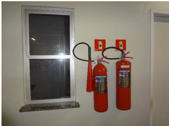
Figura 123 – Equipamentos não sinalizados
