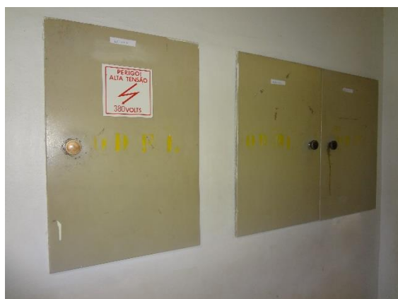
Figura 44 – Quadros elétricos expostos
