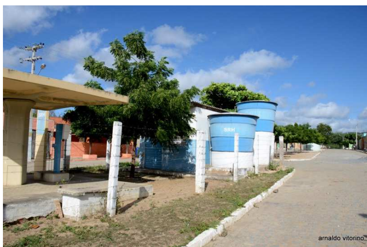
Figura 84 – Tanques de recebimento da água do poço e para a água dessalinizada e casa na qual se encontra o dessalinizador.
