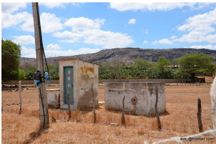
Figura 82 – Poço e casa de bombas que joga água para uma cisterna onde está também o dessalinizador.
