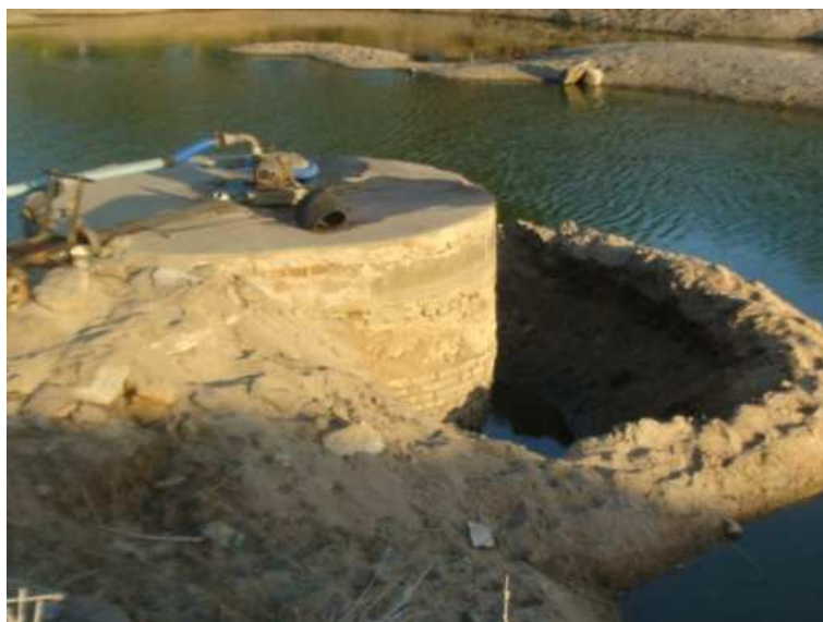
Figura 23 – Cacimbão em alvenaria de tijolo e com estrutura de bombeamento. Junto percebe-se área escavada para retirada de areia e a água aflorando. Rio Capibaribe na comunidade de Poço Fundo, Santa Cruz do Capibaribe.
