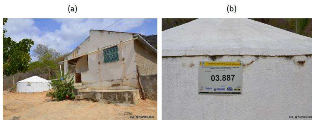
Figura 76 – Cisterna de placa e estrutura de captação de água do telhado (a). Detalhe da identificação da cisterna (b).
