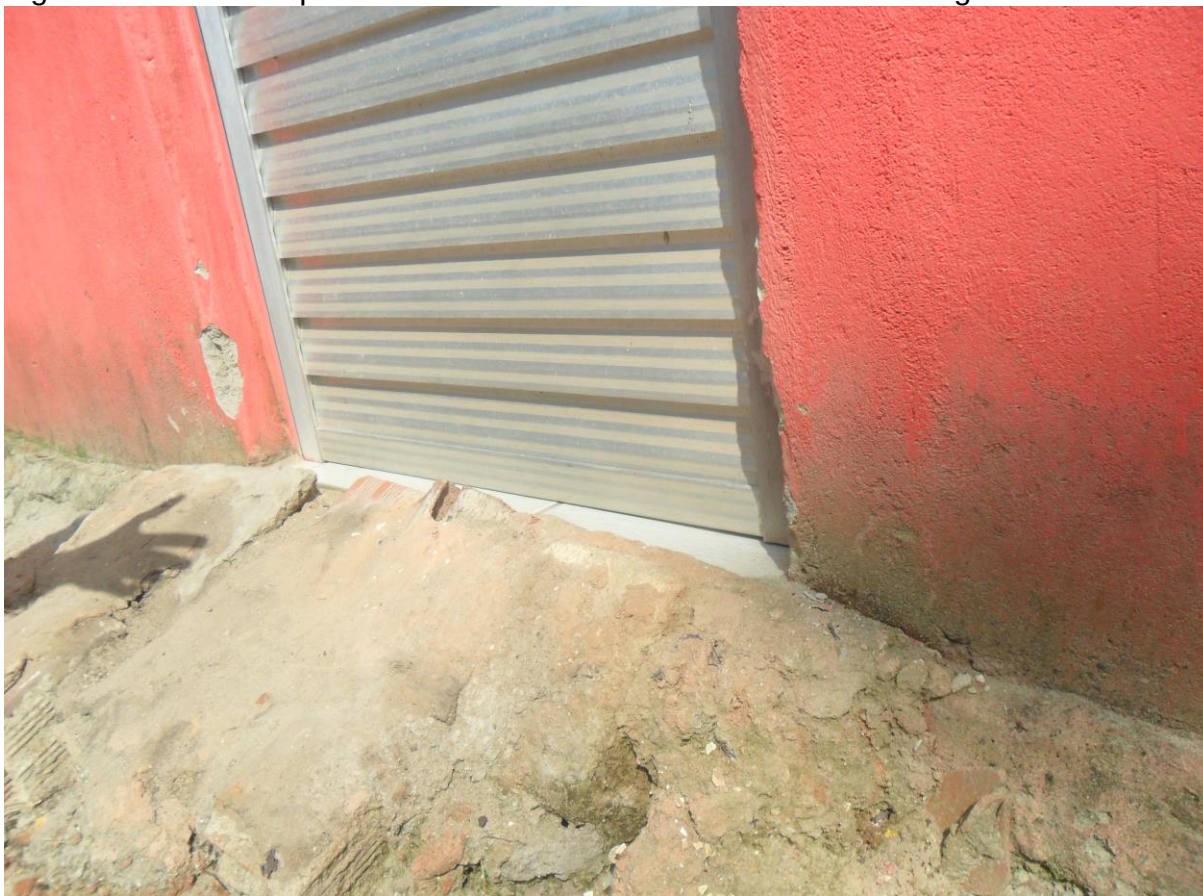
Figura 15. Marca na parede da última enchente na comunidade Eng. Mercês.
